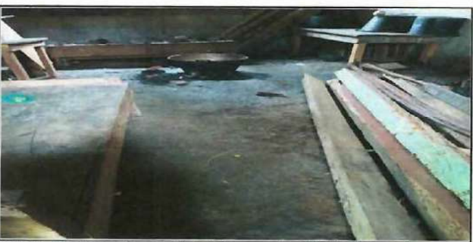
Foto 5: Se observa la necesidad de la reparacion del piso de torta de concreto.
